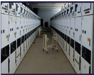
محطة محولات ميناء شرق التفريعة 22/220 ك.ف
